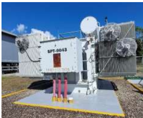
Fig. 1 Transformador que alimenta al campo. Fuente: [1]
