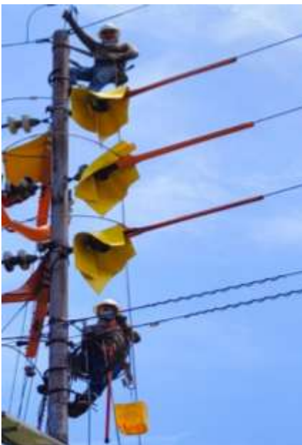
Imagen 16. MANERA DE PROTECCION EN ELEMENTOS CON TENSION EN ESTRUCTURA B3
