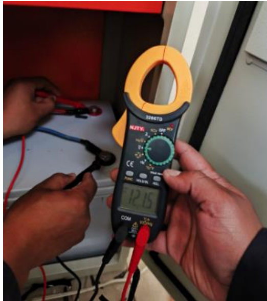
Figura 45. Medición del voltaje de la batería.
