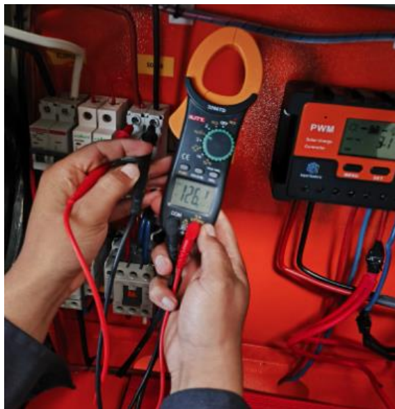
Figura 48. Medición del sistema fotovoltaico.
